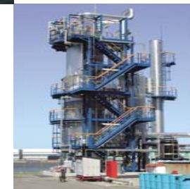
インシネレータ （廃ガス廃液焼却炉）
