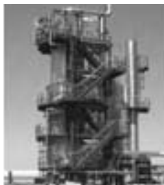
廃液・廃ガス焼却装置
