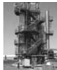
廃液・廃ガス焼却装置
