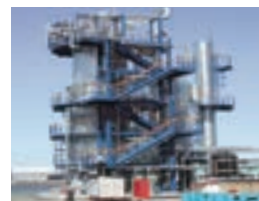
廃液・廃ガス燃焼装置
