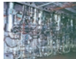
連続焼鈍設備用HRSRTバーナ
