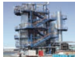
廃液・廃ガス燃焼装置
