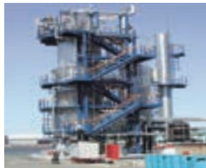
廃液 & 廃ガス燃焼装置
