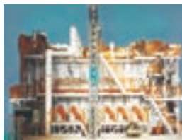
2階建AL鋳物T6熱処理炉
