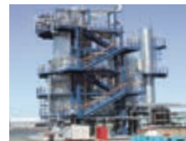
廃液・廃ガス燃焼装置
