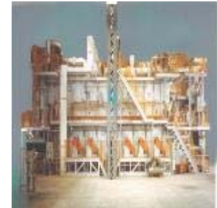
2階建 A L 鋳物 T 6 熱処理炉
